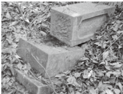
修復前の状態
